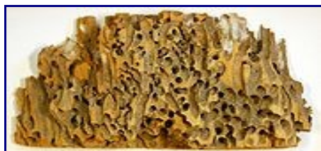
Schadbild an einem Bühnenpfahl
