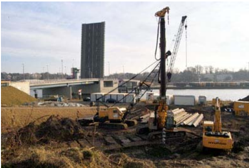
Die Fahrbahnen sind fast fertig, die neue Brücke hat aber noch zahlreiche Mängel. Foto: VG
